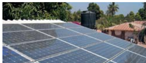
Generatore fotovoltaico in Gambia
